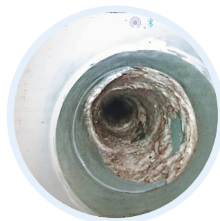
Vue caméra dans une canalisation
